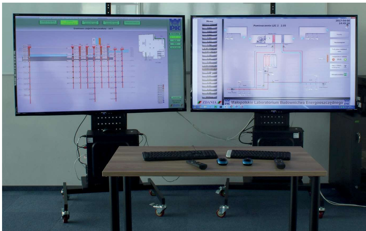
Rys. 2. Stacje operatorские zintegrowanego systemu SSO (z lewej – widok opomiarowania gruntu pod budynkiem) i BBMS (z prawej – widok jednej z pomieszczeniowych instalacji HVAC)
