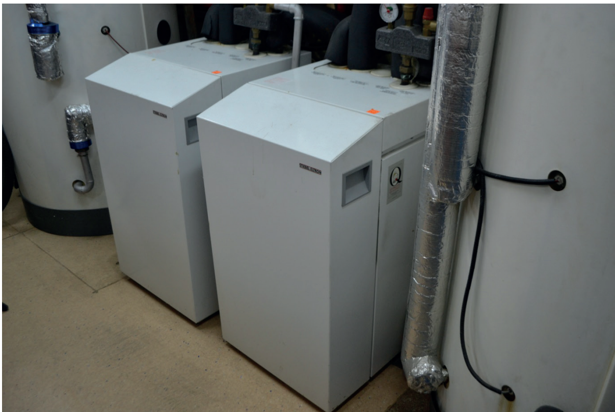
Rys. 5. Gruntowe pompy ciepła obsługujące część A Laboratorium Geoenergetyki (fot. Tomasz Śliwa)
