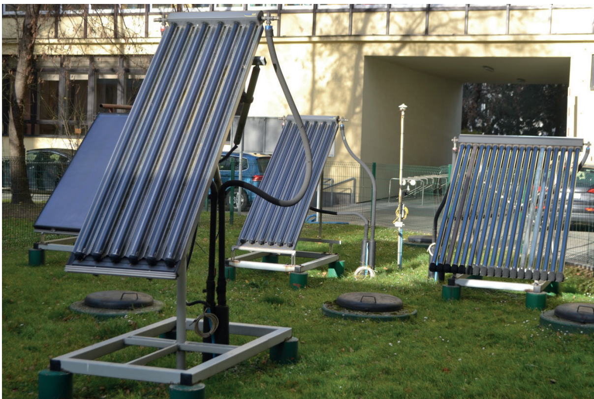
Rys. 6. Kolektory słoneczne na polu A Laboratorium Geoenergetyki służące regeneracji zasobów ciepła w górotworze (fot. Tomasz Śliwa)
