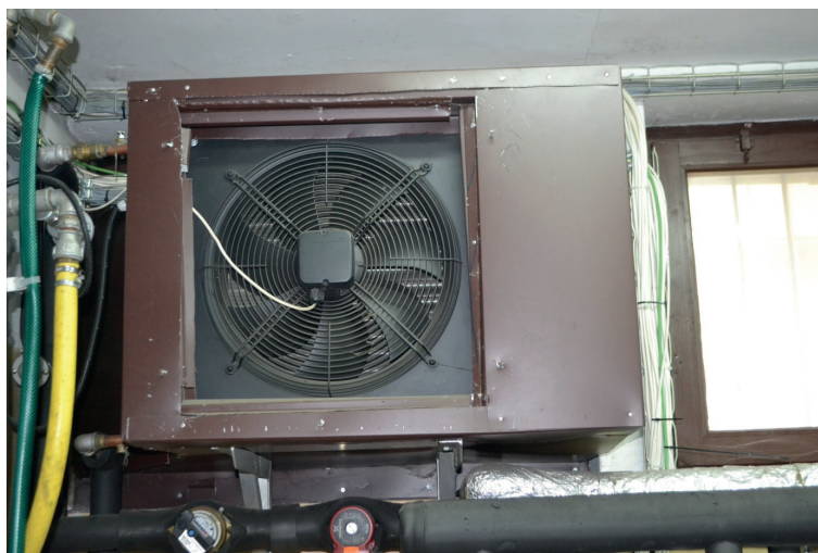
Rys. 8. Termowentylator w funkcji dry coolera (fot. Tomasz Śliwa)
