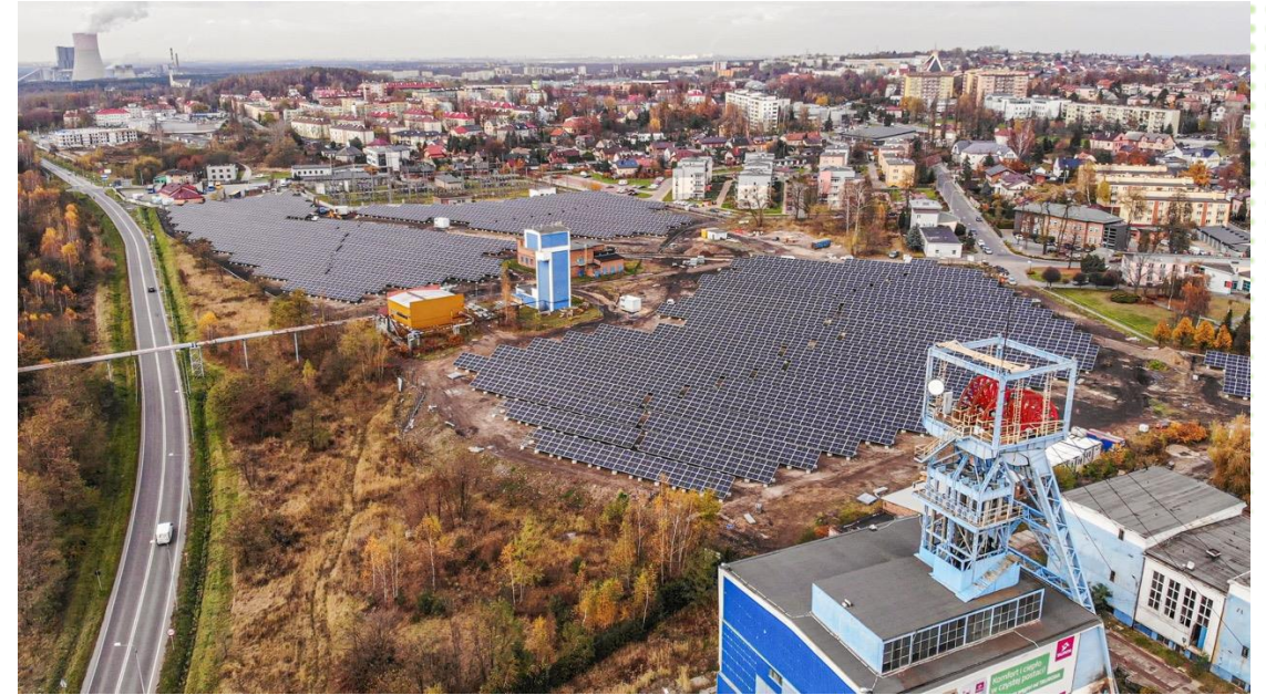
Elektrownia PV o mocy 5MWp zainstalowana m.in. na terenie kopalni oraz w miejscu zlikwidowanej elektrowni węglowej Jaworzno I. Ponad 12 tyś. modułów fotowoltaicznych
