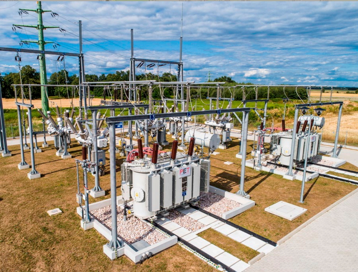
Stacja 110/15 kV Korczowa.
