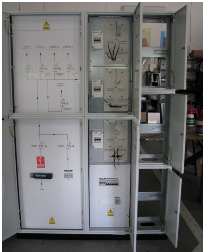
Fot. I. Rozdzielnica główna zawierająca aparat wykonawczy PWP.
