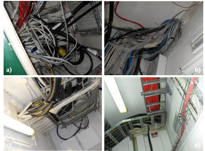
Fot. 2. Przykłady błędnego prowadzenia kabli teletechnicznych wspólnie z kablami elektrycznymi
